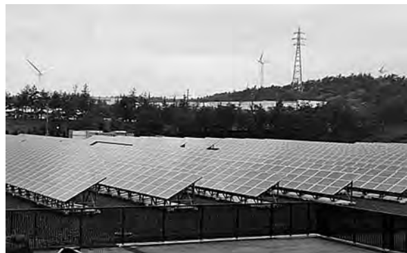
志賀太陽光発電所と福浦風力発電所
